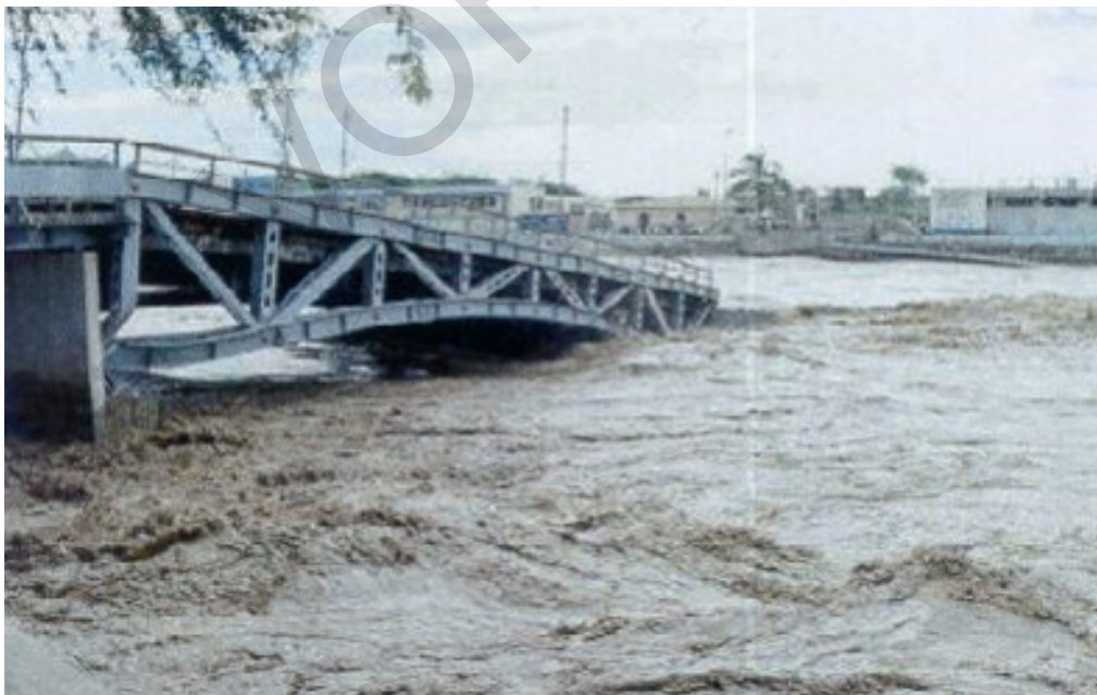
Bild 1: Zerstörung einer Brücke durch Auskolkungen (Foto: C. ALVARADO)
